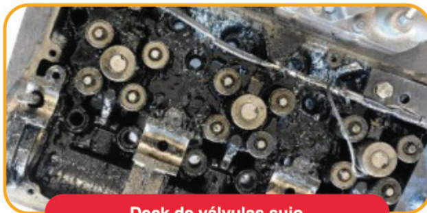
Deck de válvulas sujo
